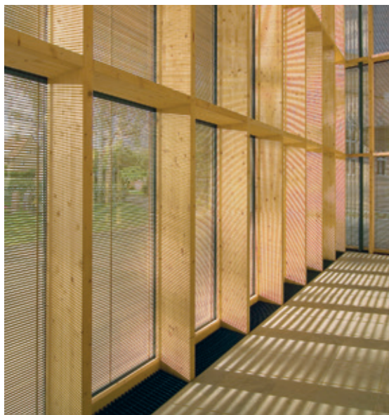
Dvojitě zasklení s vestavěnými dřevěnými roletami vytváří příjemnou atmosféru
