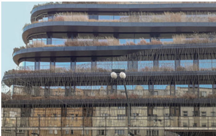
Ozdobný kovový prvek před skleněnou fasádou budovy je bezpečný, bohužel však chrání jen část skleněných ploch
