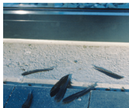
Kvůli této budově v Basileji zahynuly na podzim roku 2006 stovky sýkor uhelníčků. Peří a stopy po kolizích jsou trvalou připomínkou dramatu, která se odehrála na našich oknech.
