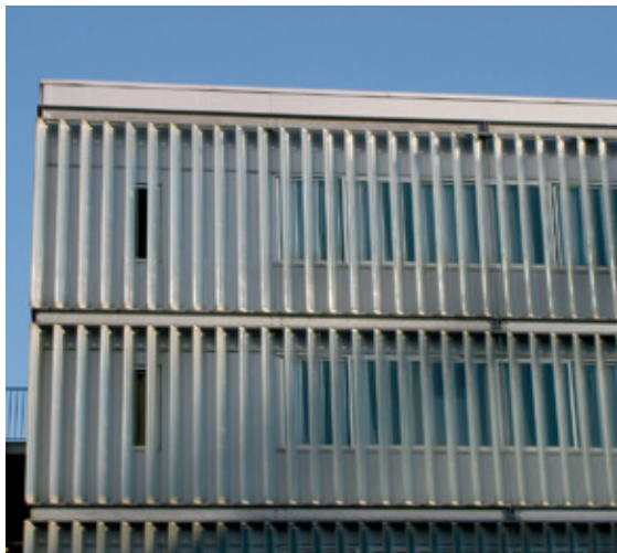
Svislé či vodorovné žaluzie zastíňují a zároveň strukturují fasádu; jsou-li nainstalovány hustě jako na tomto příkladu, je nebezpečí minimální
