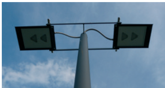
Moderní LED svítidla soustřeďují světlo na požadované místo, například na přechod pro chodce
